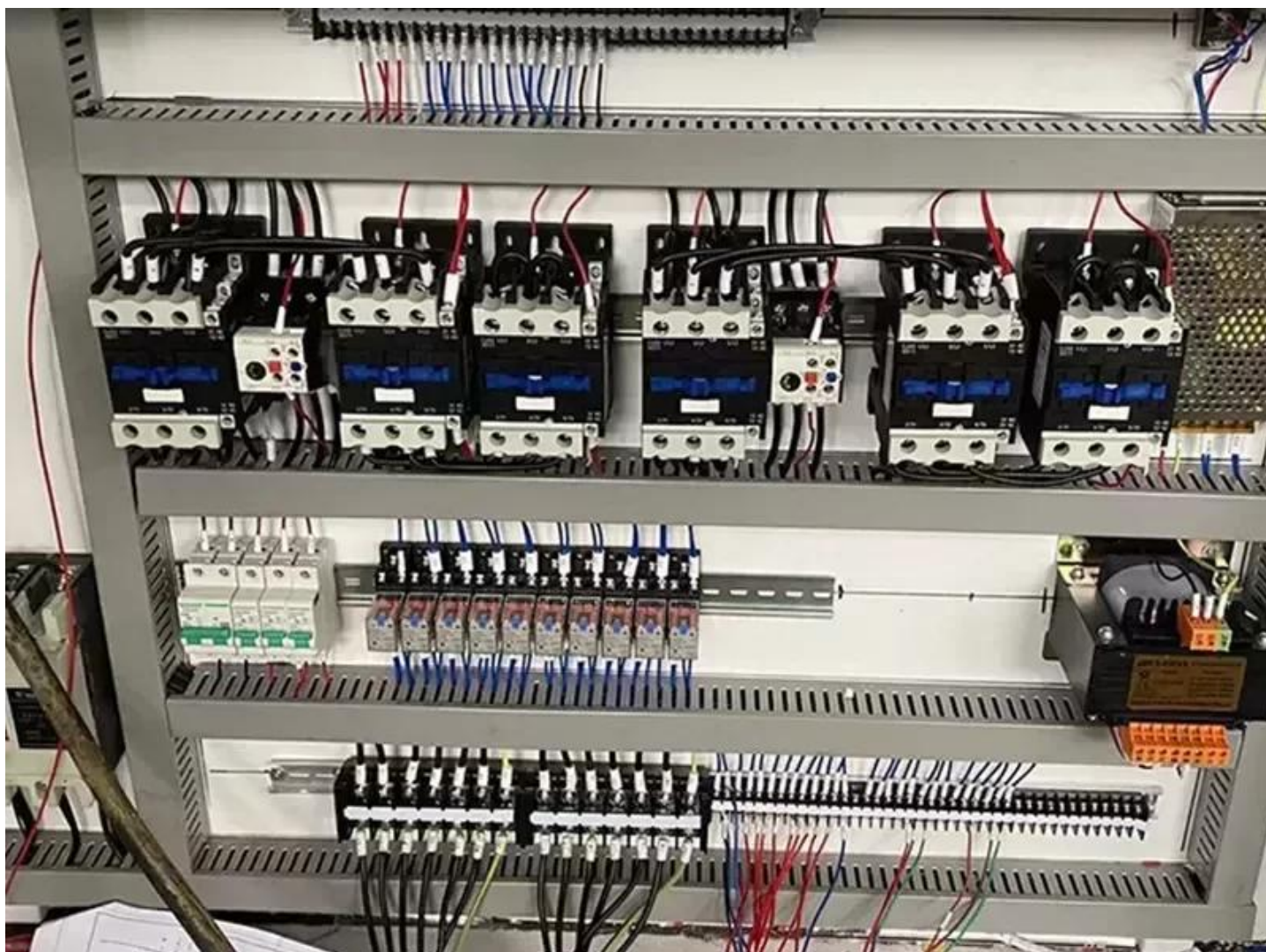
Schaltschrank und Steuerungssystem
