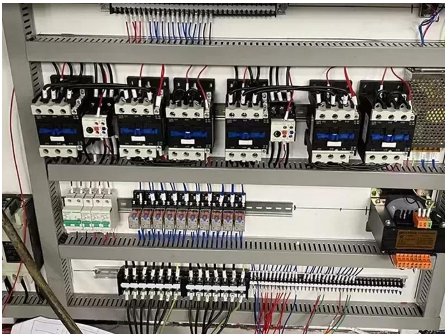
Schaltschrank und Steuerungssystem
